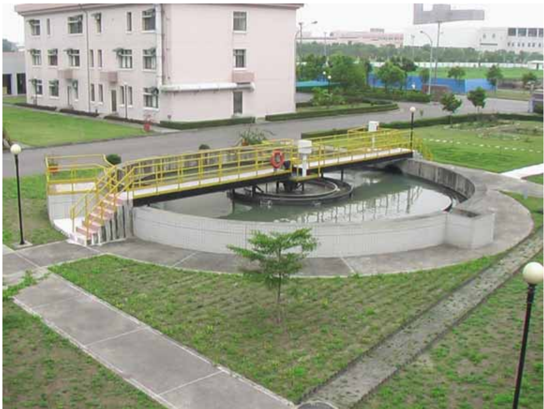
雲科污水廠二沉池
